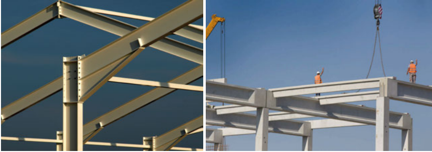
FIGURE 1.8. Les poutres et les poteaux d'une ossature en métal (à gauche) ou en béton armé (à droite) constituent des poutres au sens de la théorie des poutres : ce sont des éléments longiformes rectilignes (éléments 1D droits). © Pierre Engel et Shutterstock / Budimir Jevtic.
