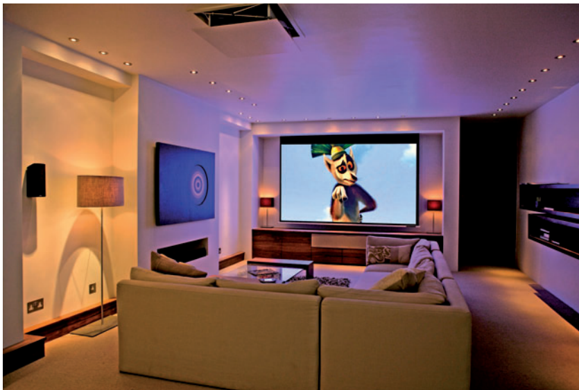
Figure 2.26 Écran électrique et vidéoprojecteur motorisé (source Pilotefilms)
