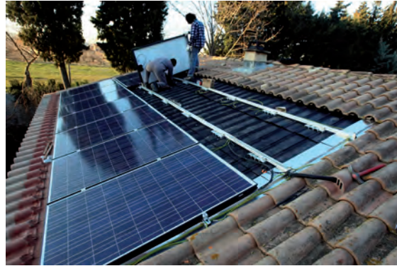
Ici, la sécurité en hauteur n'est pas assurée.
